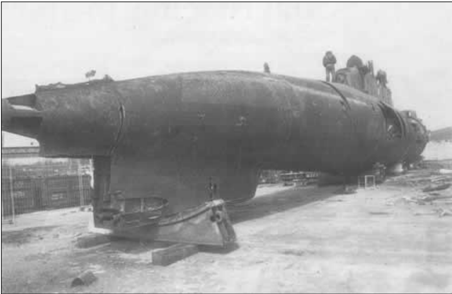
Hoher Schrottwert: U 20 auf dem Trockenen. Auf dem Gelände der Nordseewerke wird das Unterseeboot demontiert.
